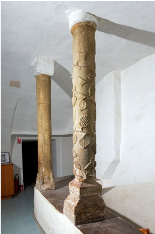
EINGANGSZUSTAND BEIDER SÄULEN (SEITLICH)
